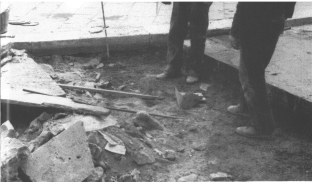
Fig. 40. I lavori di abbassamento del lastricato esterno alla Piazzetta Pedrocchi nel dicembre '83. Sulla vecchia cordonata si nota il segno del livello originario della strada.
