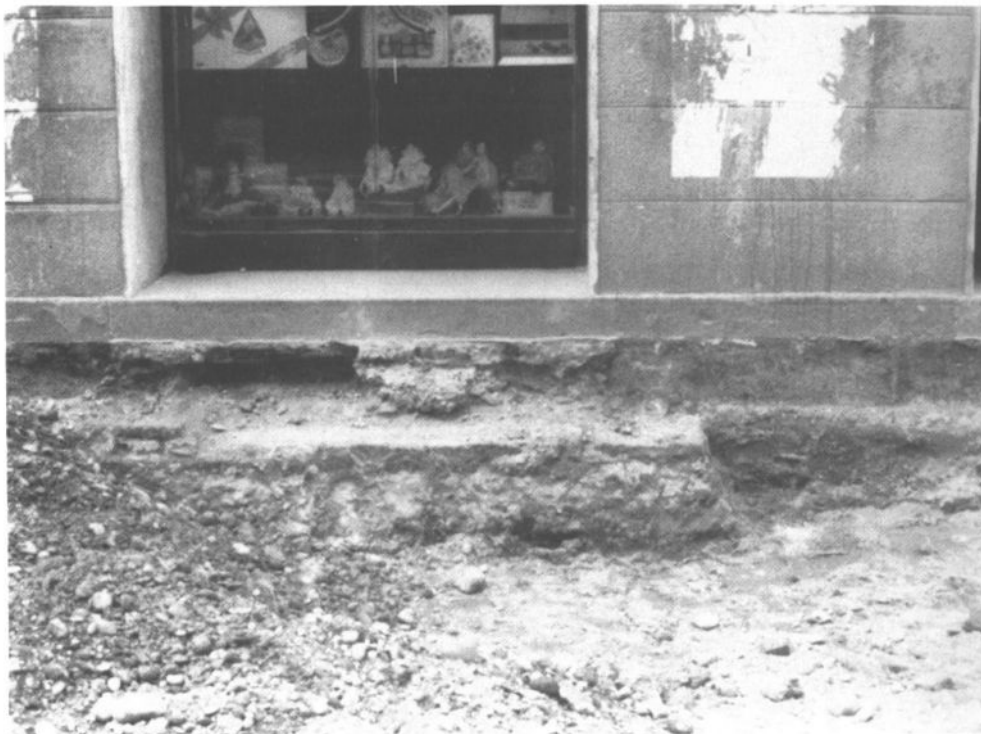
Fig. 42. La fondazione del gradino davanti alle tre porte centrali del Pedrocchi in via 8 Febbraio, ritrovata sotto il marciapiede demolito.
